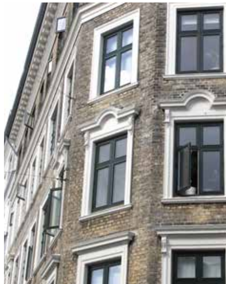
Støjsolerende trævinduer med koblede rammer. Istedgade 128 / Dehlenschlægersgade 50-52, København V.
