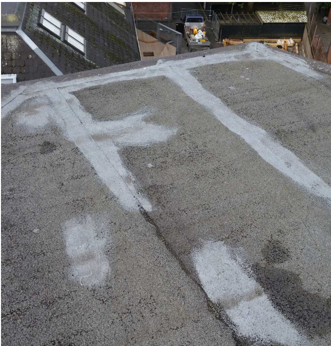
Taget er væsentligt nedslidt.
