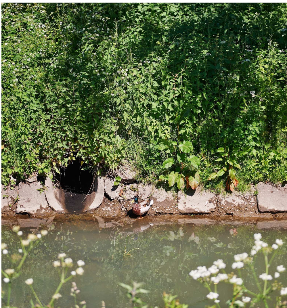
Regnvandsudløb ved Harrestup Å. Foto: HOFOR
