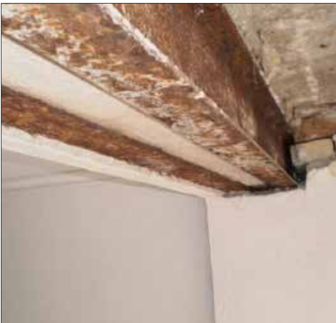
Karnappernes jernprofiler er korroderede.
