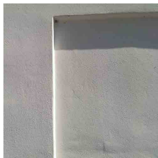
Detaljer. Resses i pudset overflade
