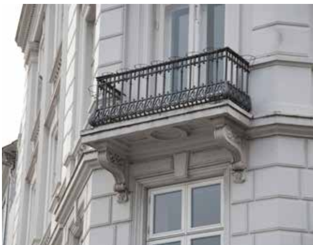
Foto 21. Altanbunden er dekoreret, forkanten er profileret og bunden indgår naturligt med gesimsen.
