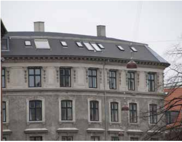
Foto 14. Små og store tagvinduer i en blanding uden rytme og harmoni. De små tagvinduer er sandsynligvis originale, mens de store tagvinduer er en senere tilføjelse.
