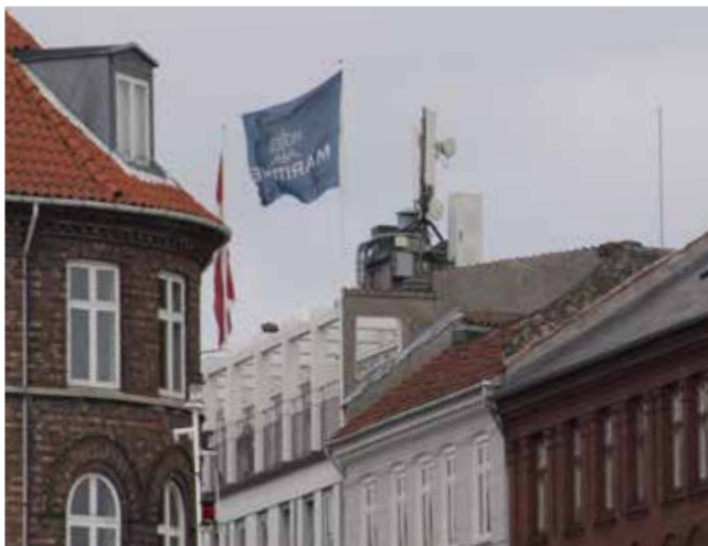
Foto 17. På taget ses en uheldig samling af tekniske installationer, som med fordel kunne være placeret integreret i bygningen eller være blevet dækket ind.
