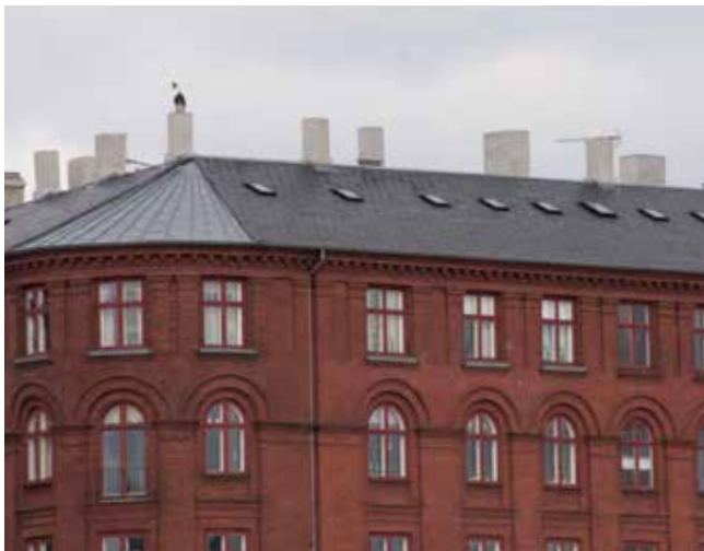
Foto 4. Små tagvinduer placeret rytmisk. Der kan i dette tilfælde fjernes mange skorstene, da de ikke er karaktergivende for bygningen.
