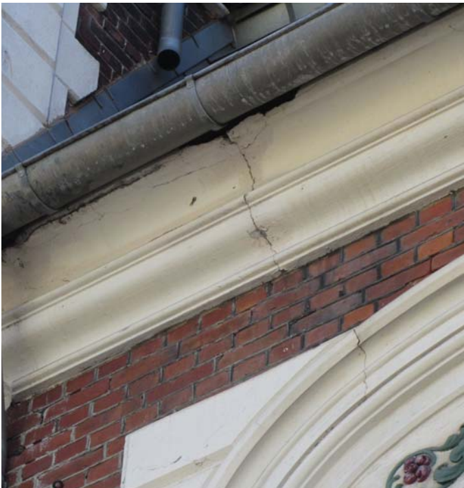
Der ses store sætningsrevner på gadefacaden
