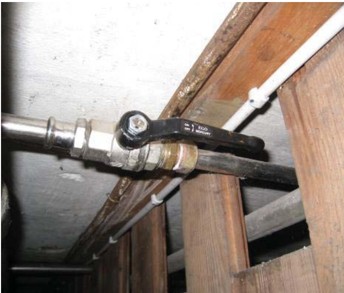
Uisolerede varme og vandrør isoleres
