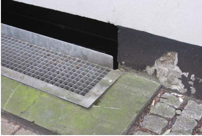
Sokkel har mange steder større afskallinger
