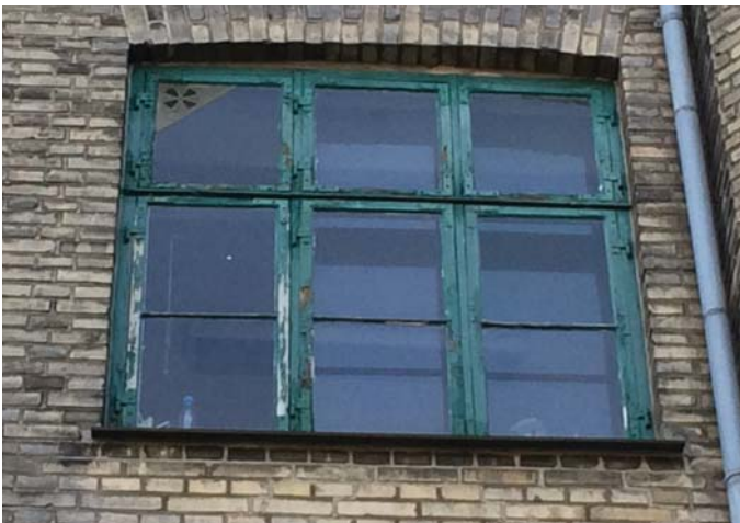
Vinduer mod gård er nedslidte og skal skiftes
