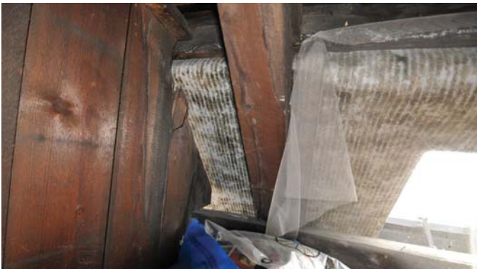
Skimmel på tagkonstruktion udbedres og ventilation forbedres
