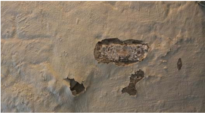
Fugt i kældervægge pga. dårlig ventilering
