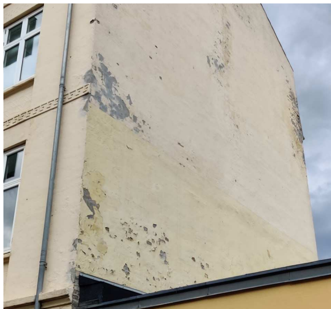
Gavle er nedslidte og uisolerede
