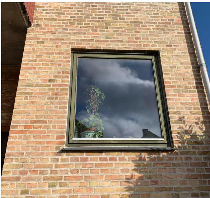
Eksempel på udtjent vindue
