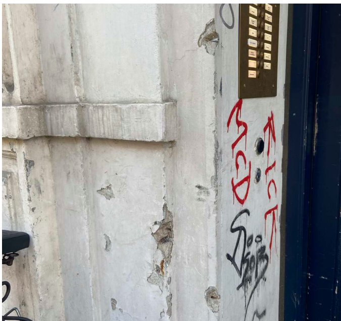
Facader er nedslidte
