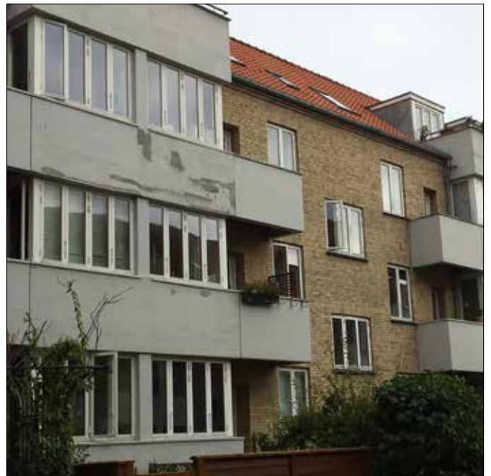
Bygningens 10 karnapper er nedslidte. De skiftes og isoleres.
