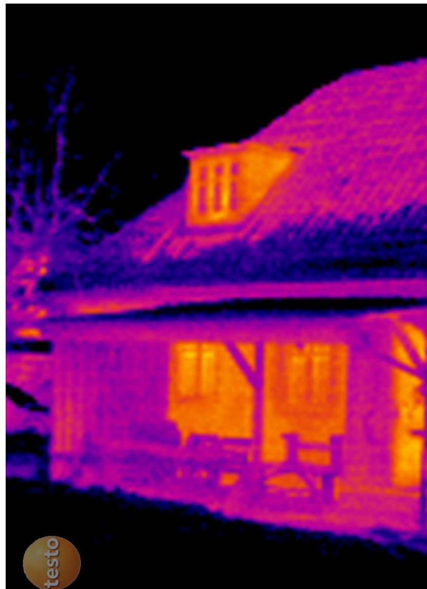
Det fremgår tydeligt af dette termografiske foto, at der strømmer varme ud gennem både tag og vægge samt i særdeleshed kviste, vinduer og døre
