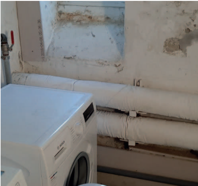
Ny varmecentral og tilslutning til fjernvarme
