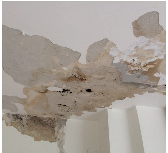
Tegn på fugt grundet uisoleret fladt tag
