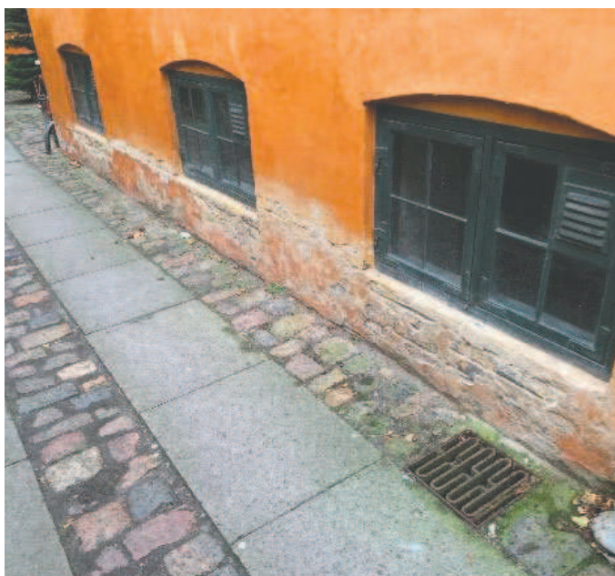
Den afskallede puds er tegn på fugtproblemer
