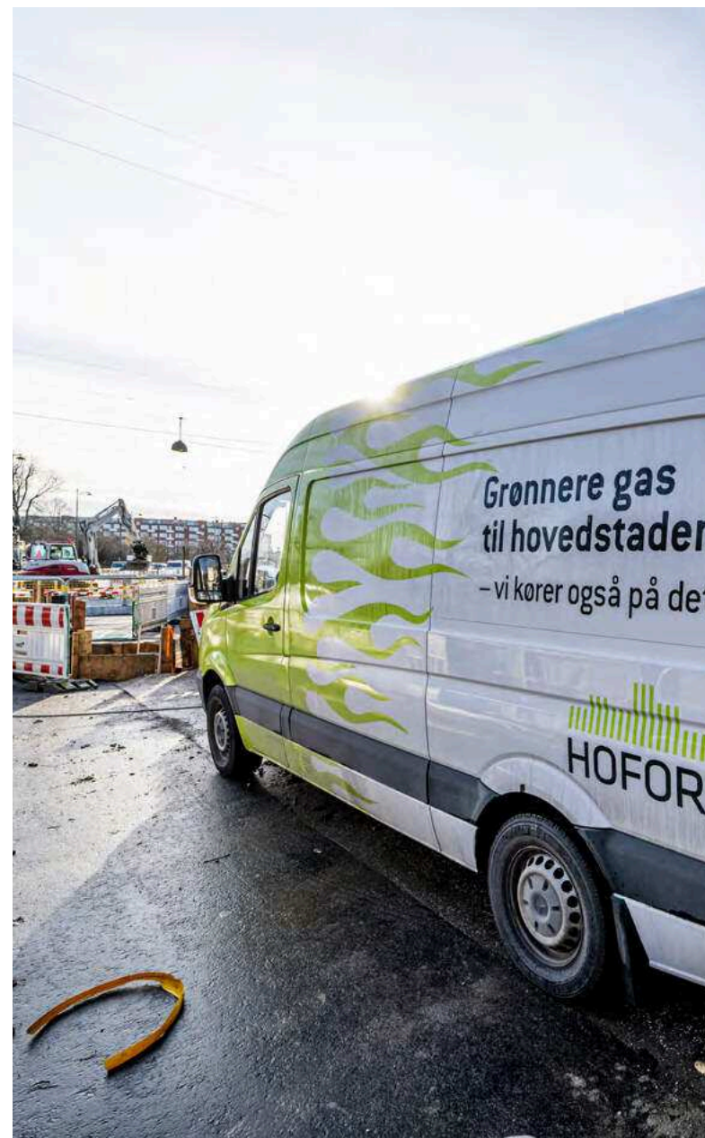
HOFOR forventer at kunne levere 100 pct. CO 2 -neutral bygas fra 2026
