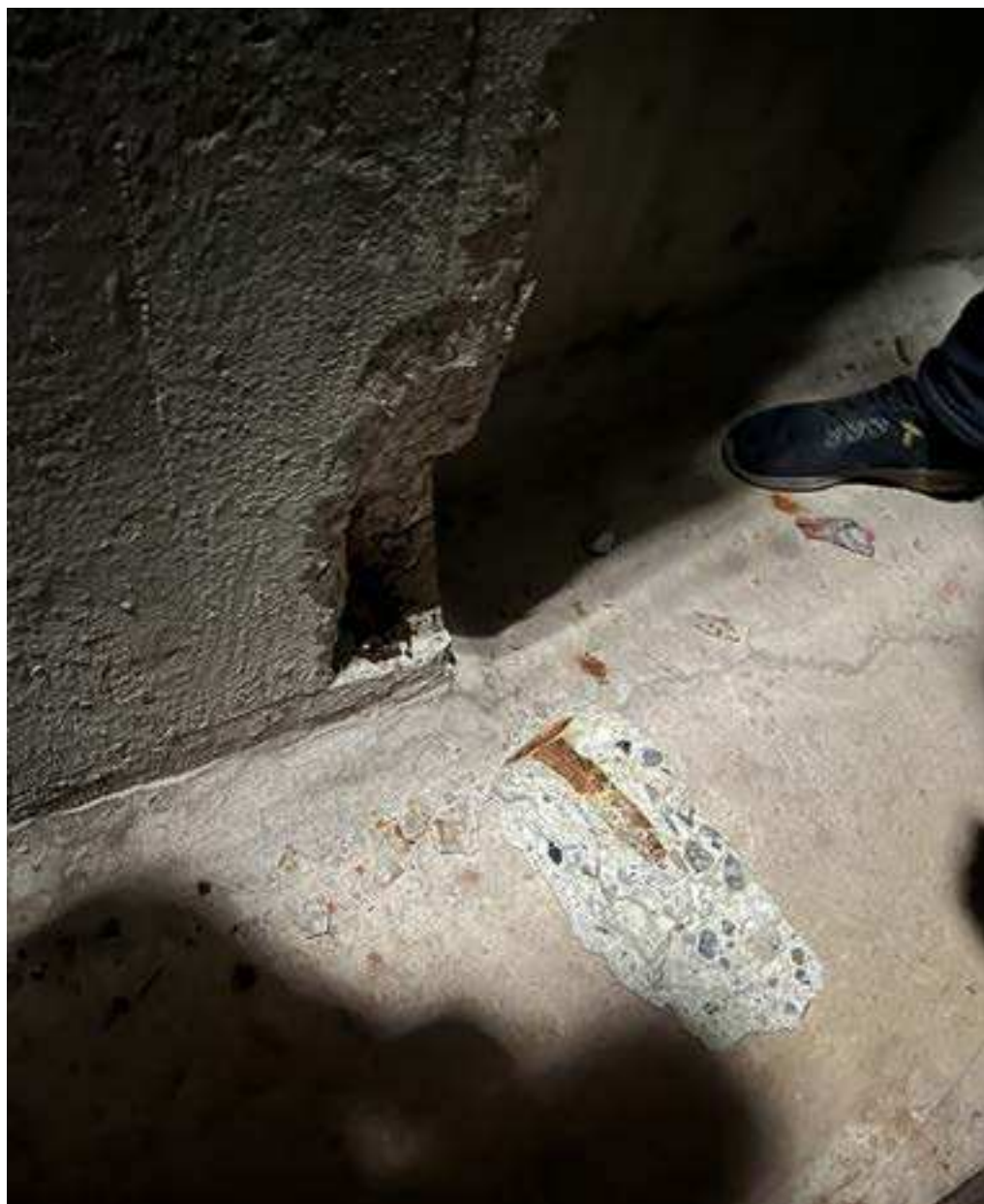
Udvendig og indvendig istandsættelse af betonen er nødvendig ifm. ibrugtagning af tekniketagen og vandtanken.
