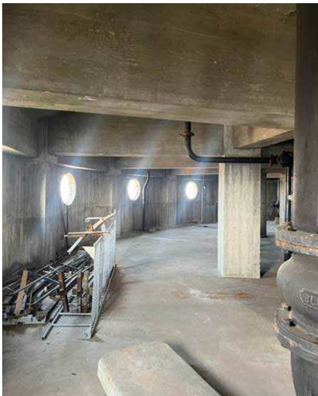
Tekniketage og vandtank.
