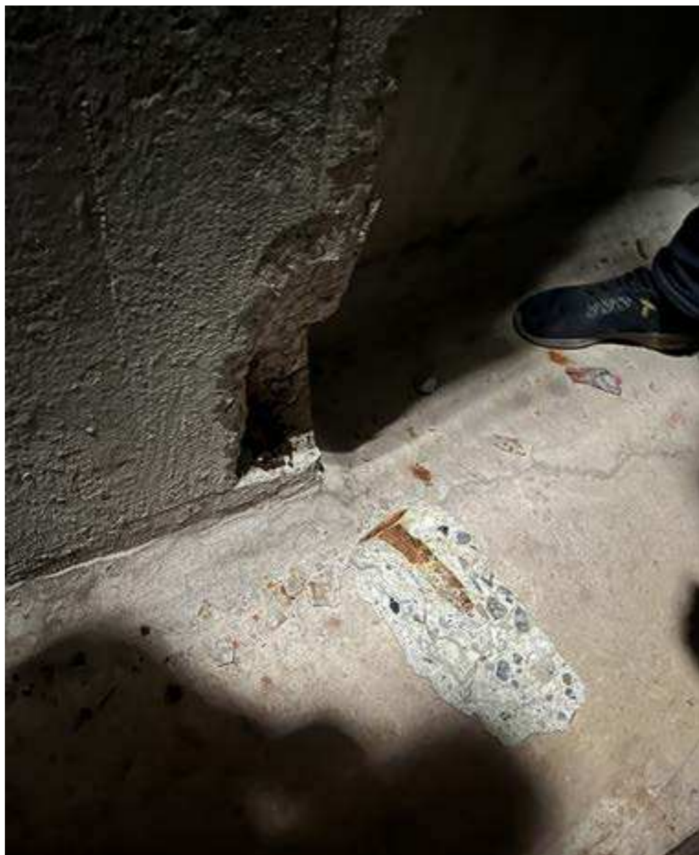
Udendig og indvendig istandsættelse af betonen er nødvendig ifm. ibrugtagning af tekniketagen og vandtanken.
