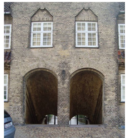
Porte med adgang fra På Bjerget til C. J. Birkedalsvej - bemærk murdekorationer over vinduerne og de murede buer i portene
