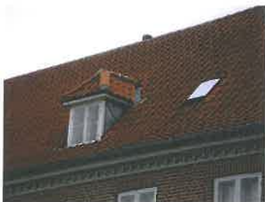
Peter Rørdamsvej 24-28 13 stk. GVO-tagvindue placeret mod gade
