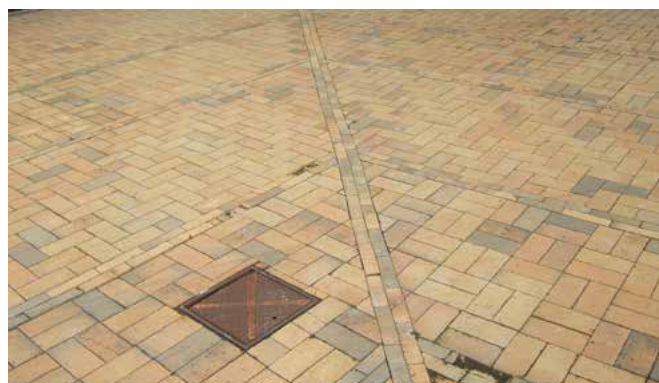
Sammenskæring og vandrende i teglbelægninger.
