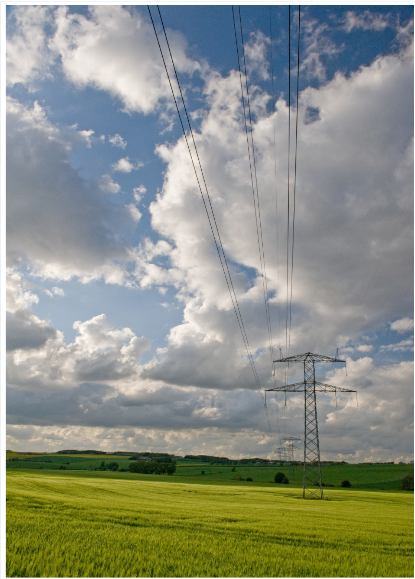
Masterække med et 400 kV ledningssystem og et 150 kV system. Når to systemer samles på én masterække, bliver magnetfelterne ikke automatisk dobbelt så store. De kan i nogen grad udligne hinanden.
