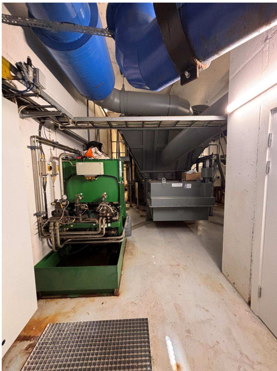
Foto 1: Nyhavns sug - underjordisk terminal
