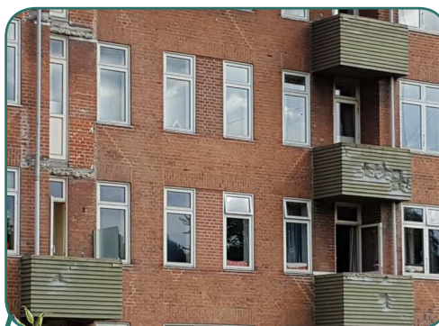
Altaner i Bavnehøj, der er ved at falde sammen. Bygninger fremstår nedslidte.
