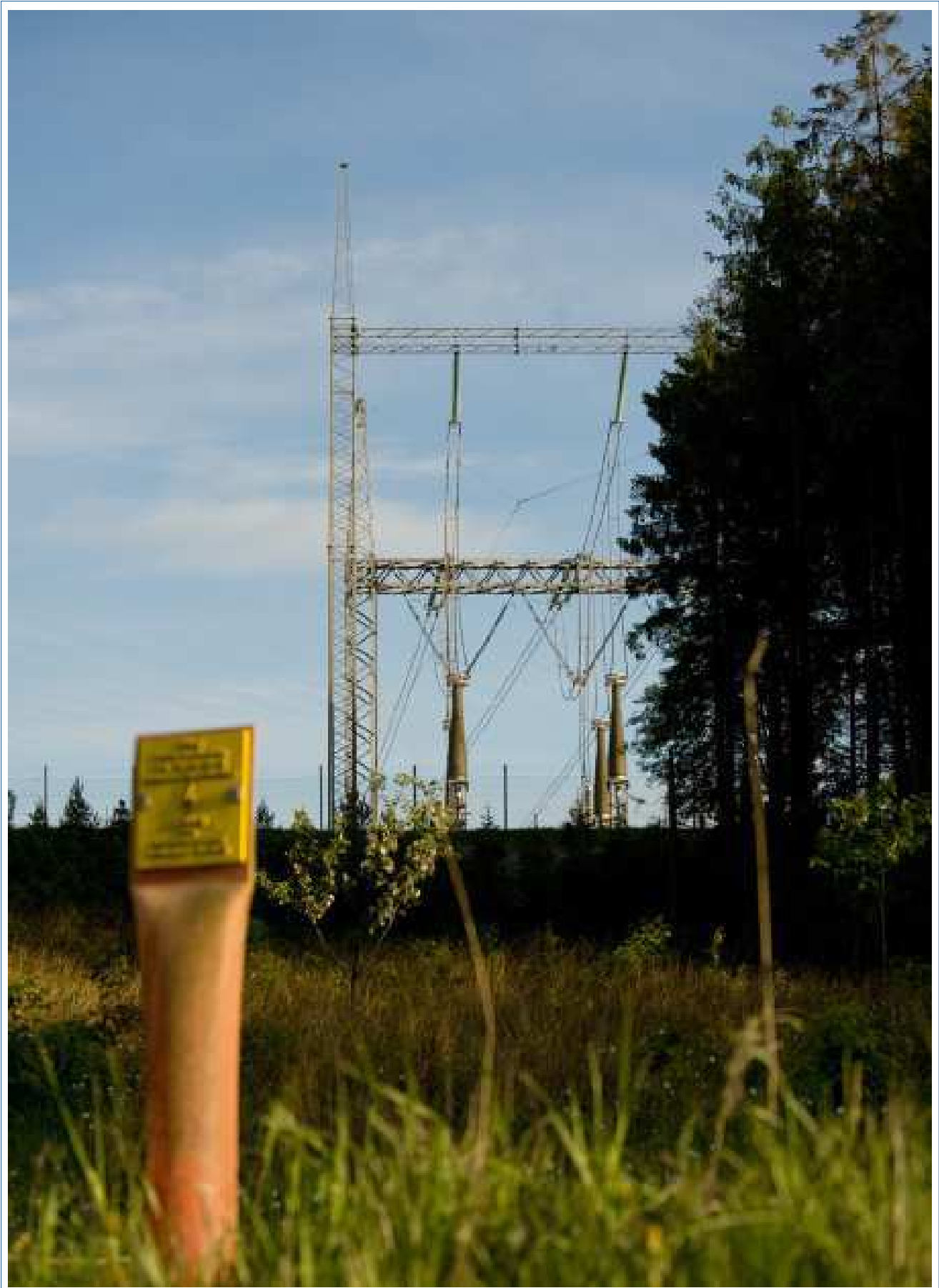
I en kabelstation føres ledningerne ned i jorden. En pæl markerer, hvor kablerne er nedgravet. Også ved jordkabler er der magnetfelter. Se eksempler i "Katalog over magnetfelternes størrelse ved forskellige anlægstyper".
