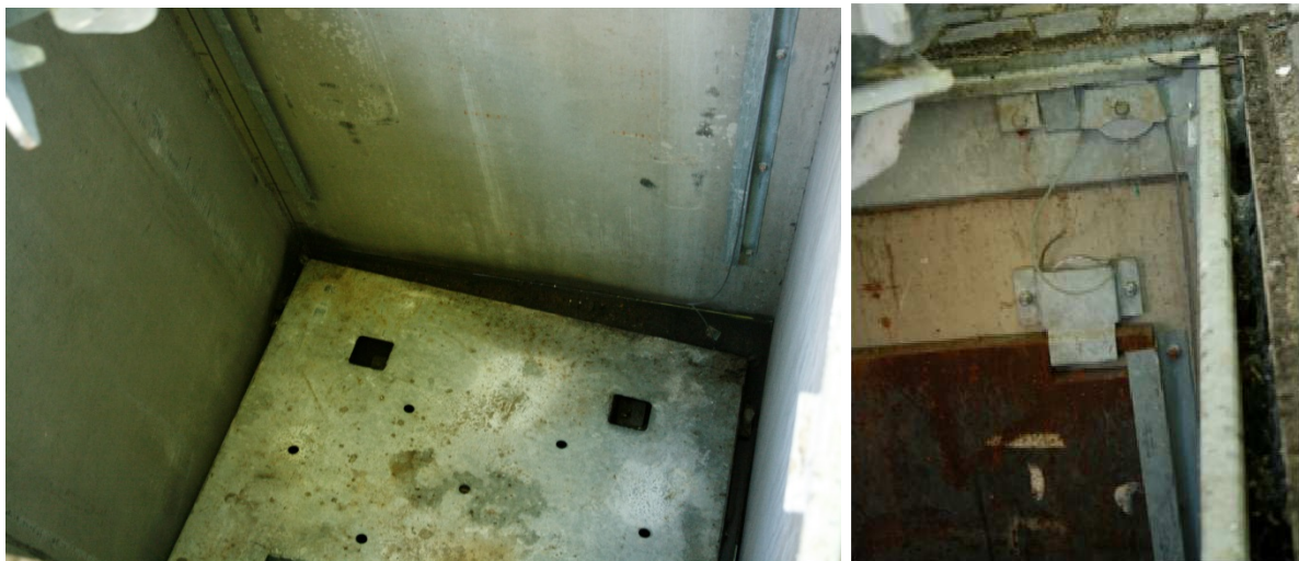
Figur 4.9 Sikkerhedspladen forbliver på bunden af betonkummen, da wire i systemet er knækket.
