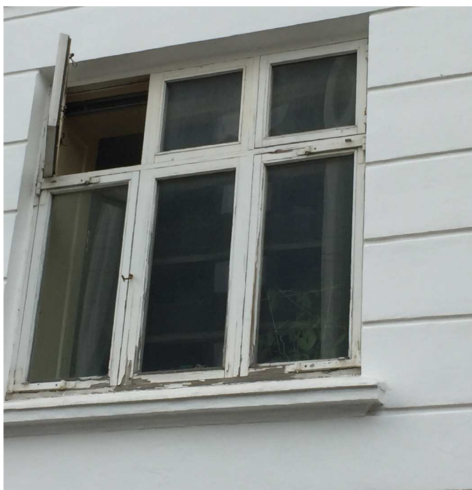
Ejendommens vinduer er nedslidte og udskiftes.
