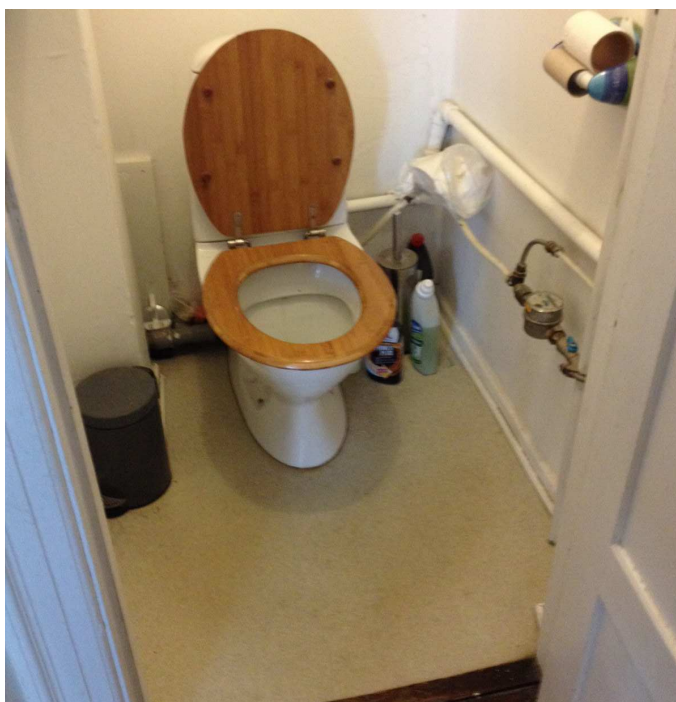
Ejendommen har utidssvarende toiletter uden bad.
