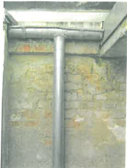
3. Bagfald/nedsivning af vand fra nabobygning ved gavl
