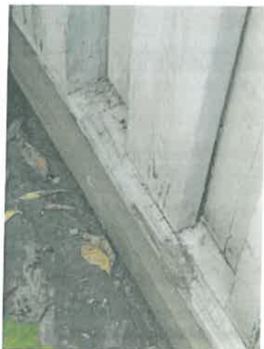
2. Fugt fra plankeværk/mangl. afdækning af kant
