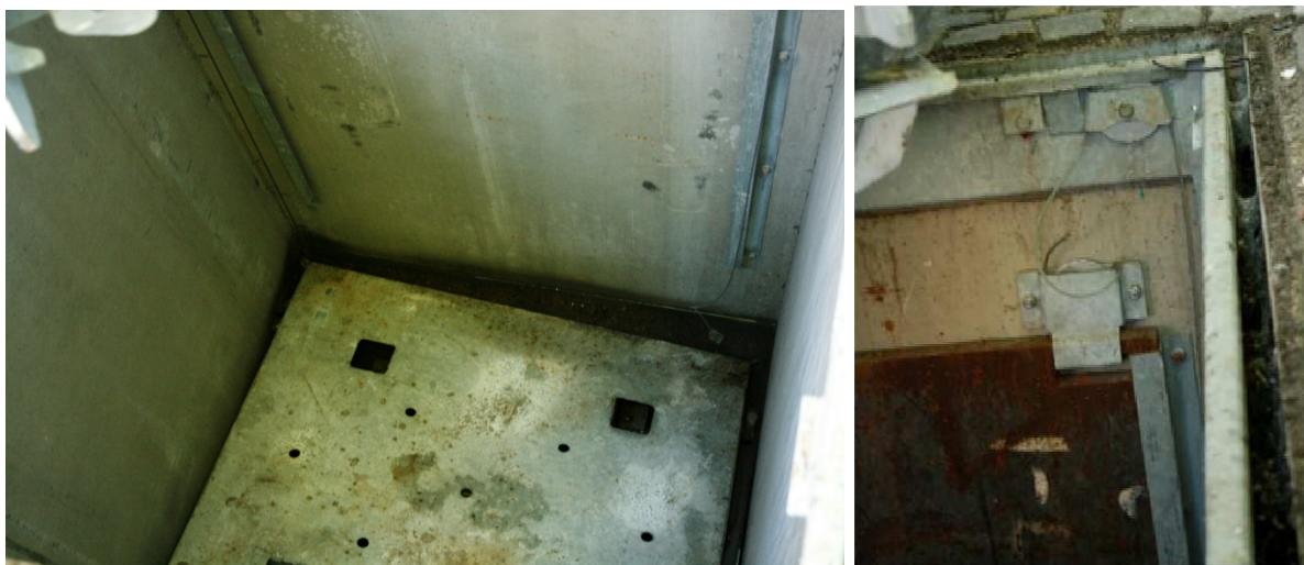
Figur 4.9 Sikkerhedsgulvet forbliver på bunden af betonkummen, da wire i systemet er knækket.
