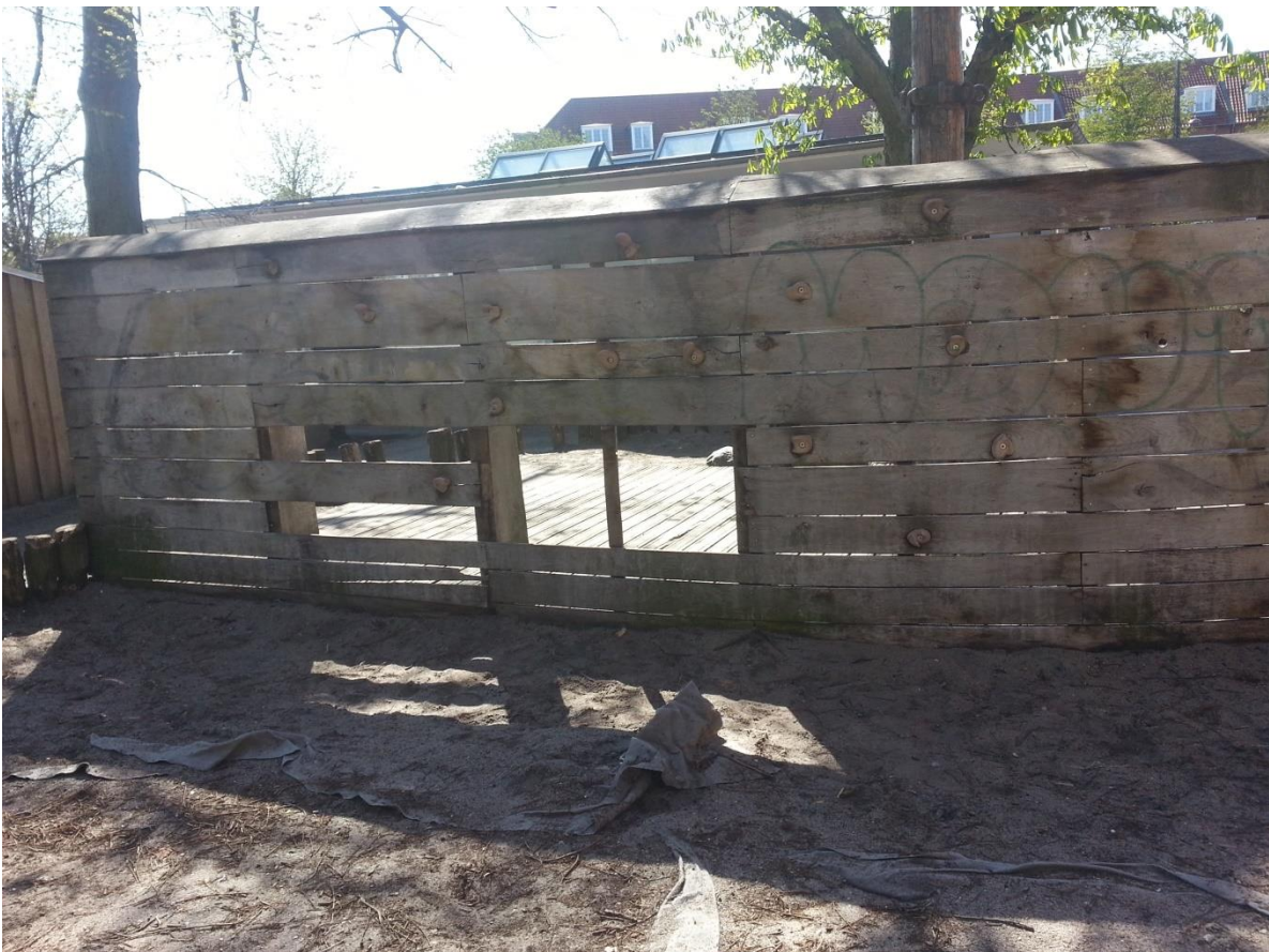
Huller og løse brædder i klatrevæg
