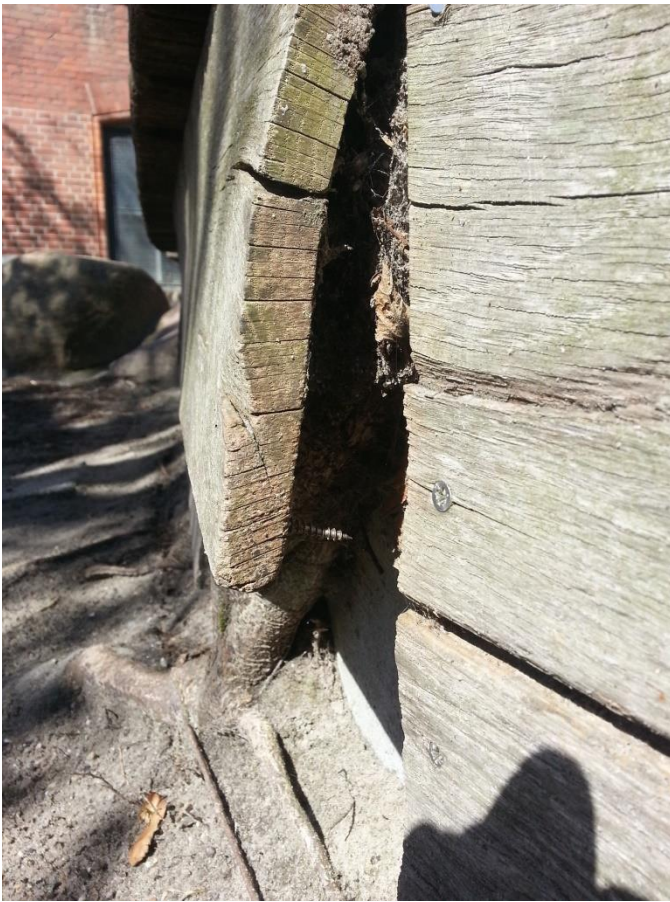
Udstikkende skruer og løse brædder
