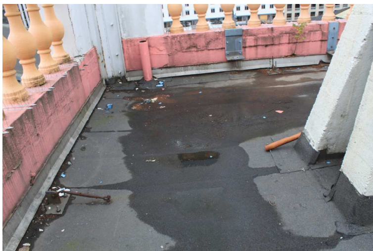
Beslag og bygge affald mv. på tag- flade
