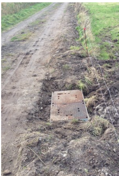
Eksempel på teknikbrønd med dæksel i terræn
