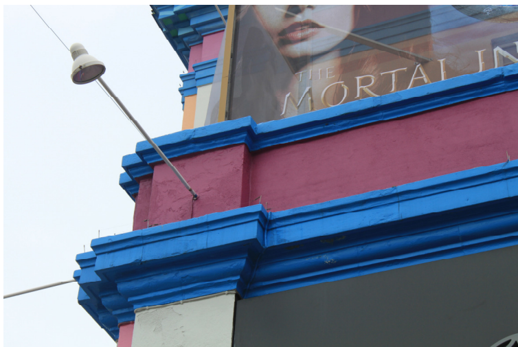
Belysningsstander på facade
