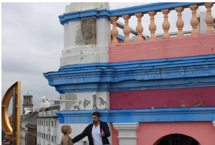
Tydelige skader på yderside af tårn
