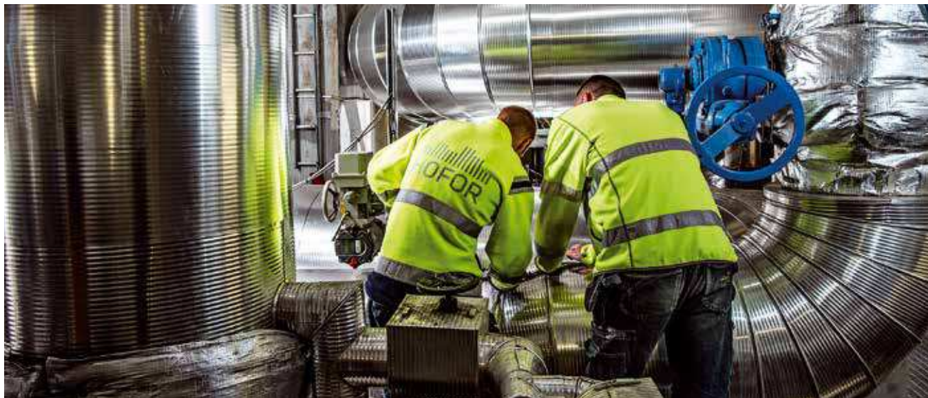
Fjernvarmerør i centralen under Adelgade
