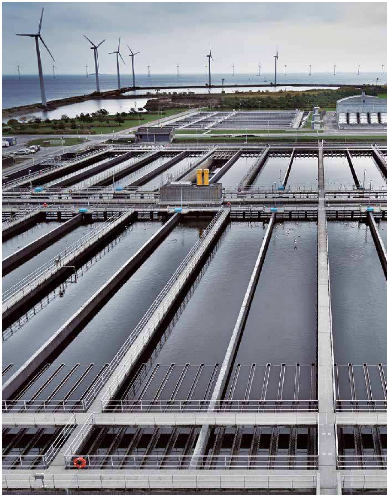
Rensebassiner ved Renseanlæg Lynetten.
