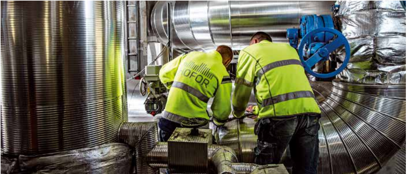
Fjernvarmerør i centralen under Adelgade
