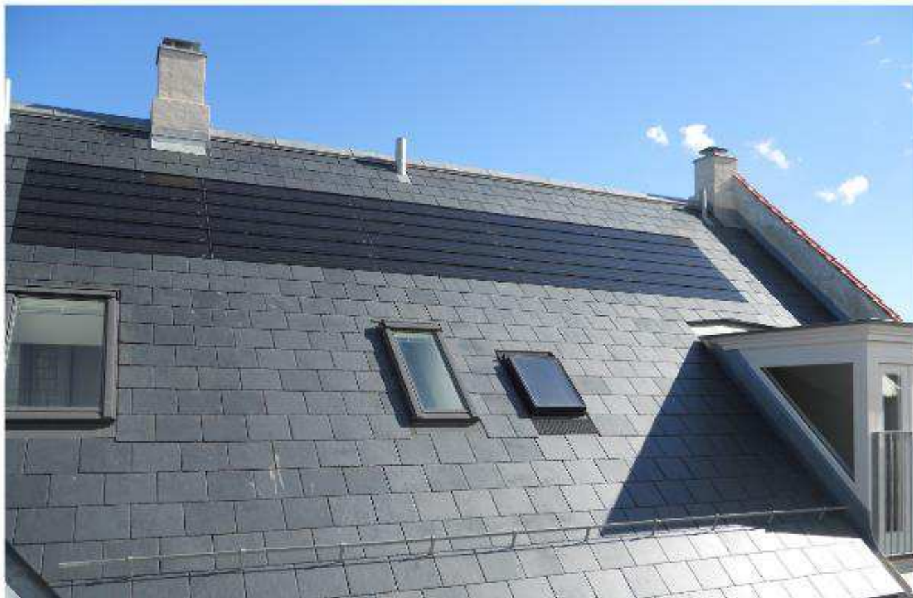
Baldersgade, integrerede solceller
