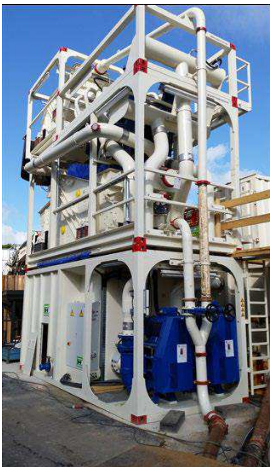
Figur 5.11 Separationsanlæg til slurry.
