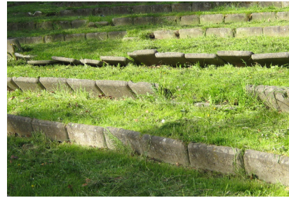
Siddekanterne bør renoveres med en kombination af nye og genbrugte betonsten, og siddepladserne rettes op
