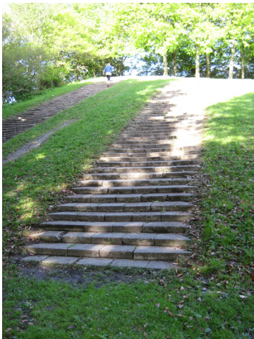
Trapperne langs scenens sider bør udskiftes med nye betontrin
