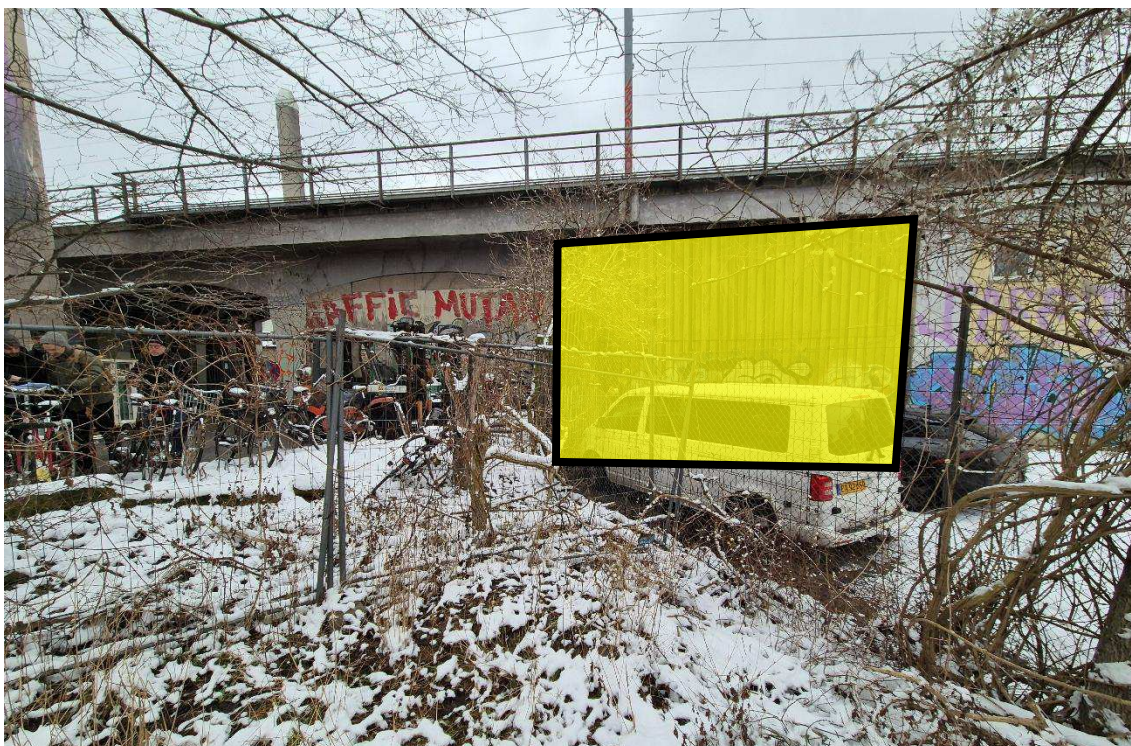
Figur 26 markering af gennembrud under højbanen fra øst, fra El-forbundets grund. Bemærk niveauforskellen til nabogrunden.
