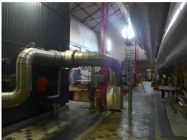
Olieyr og røggasrør i maskinhallen
