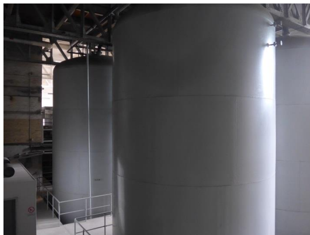
Olietanke i kedelhuset
