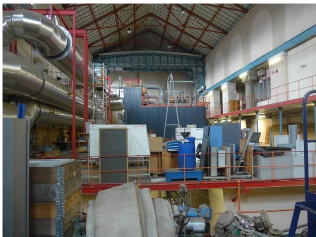
Maskinhallen med de 3 oliefyr og røgrør
