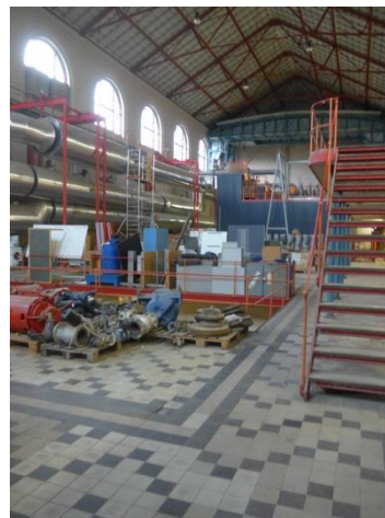
Maskinhallen med oliefyr og røgrør
