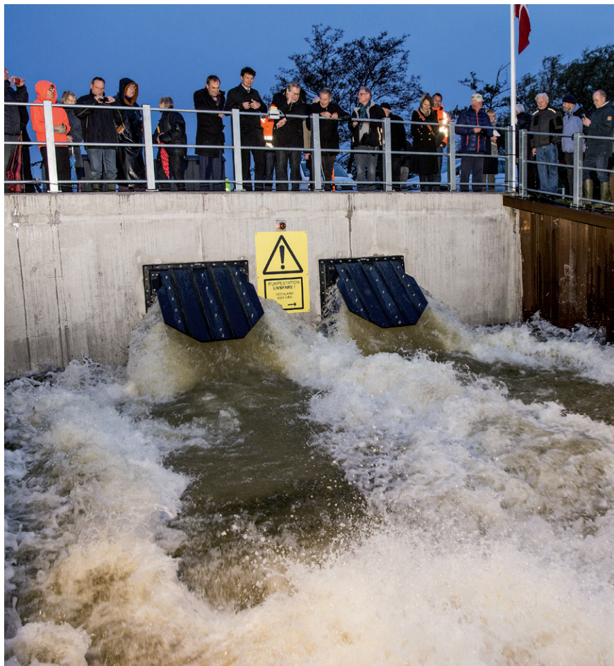
Vandet fossede ud ved den nye pumpestation, som markerede afslutningen på det store projekt med at klimasikre langs St. Vejleå.
