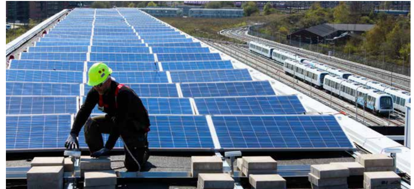
Kontrol- og vedligeholdelsescenteret i Vasbygade blev i 2016 udstyret med solceller.
