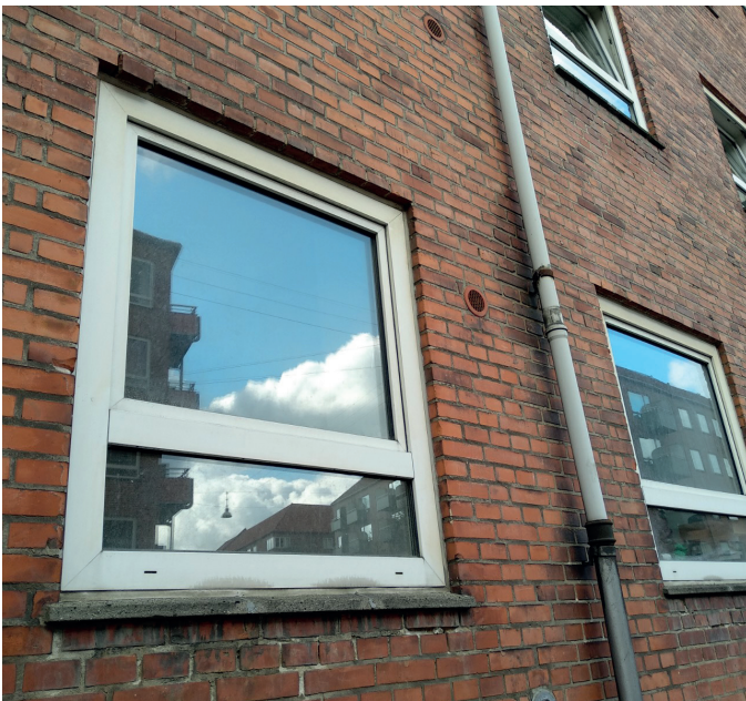
Eksisterende plast-vinduer i dårlig stand udskiftes.
