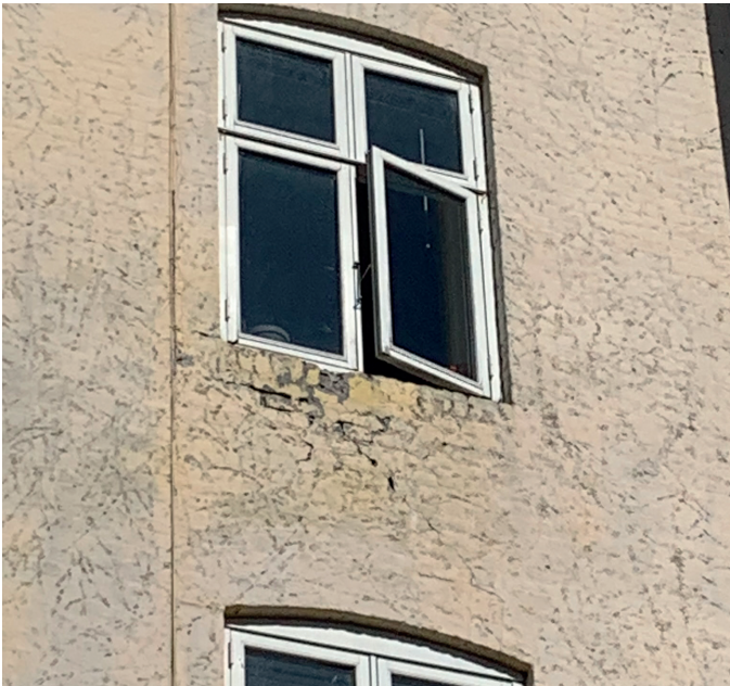
Ejendommen har en del revner i facaden, der udbedres.
