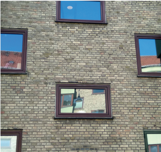
Ejendommens vinduer er i en ringe kvalitet, og udskiftes.
