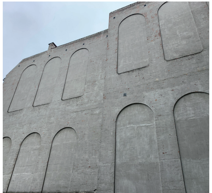
Ejendommen har store kolde gavle, der efterisoleres.
