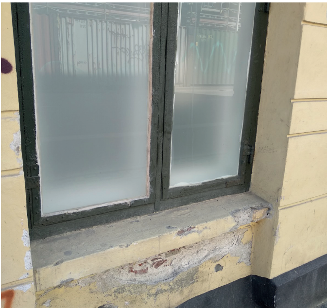
Ejendommen er meget fugtpletet.
