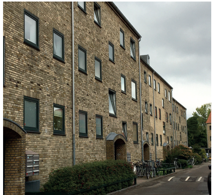
Utætte vinduer udskiftes.
