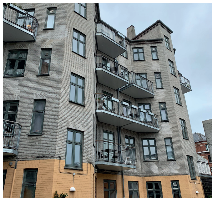
Utætheder og revner i facader udbedres.
