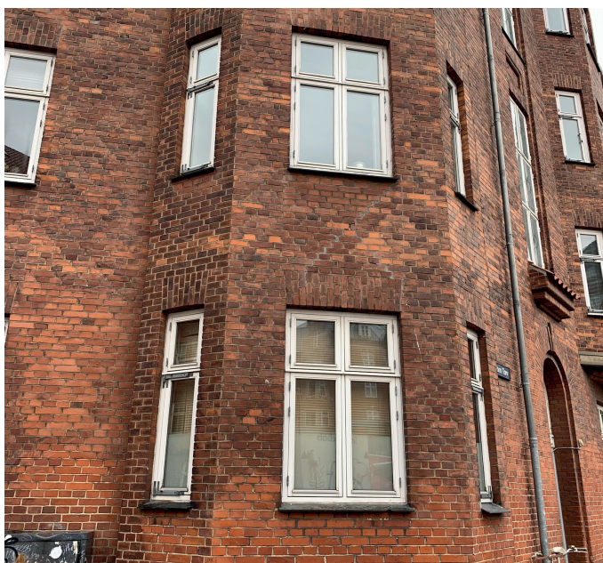
Ejendommens vinduer er af en ringe kvalitet, og udskiftes.
