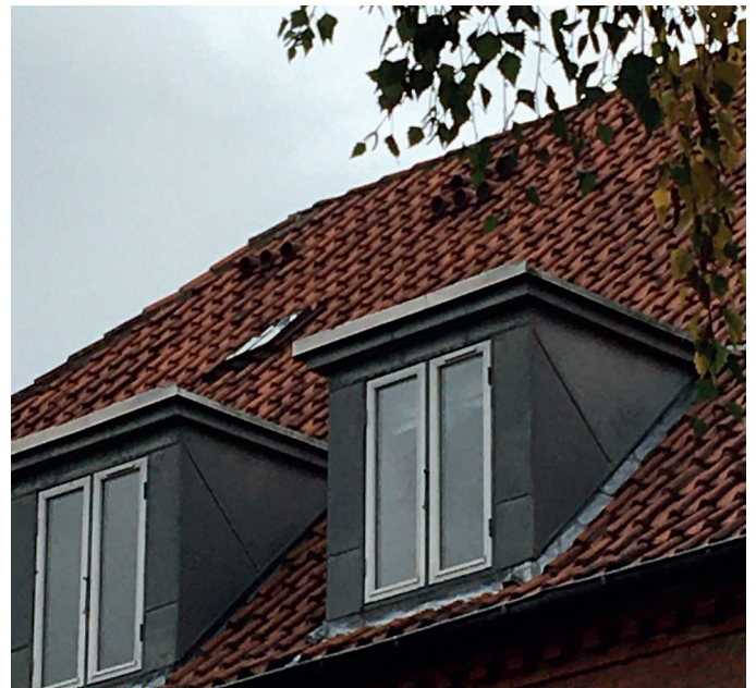
Taget er nedslidt. Boliger i tag efterisoleres.
