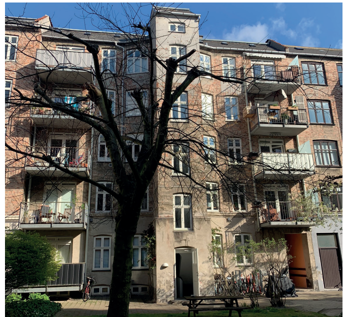
Ejendommen set fra gården. Revner udbedres.
