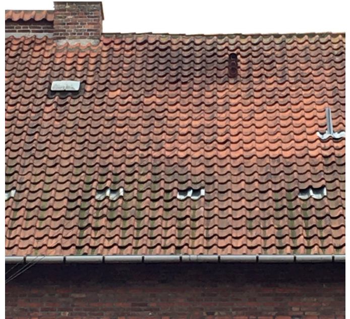
Tag er nedslidt og udskiftes til nyt med integrerede solceller.
