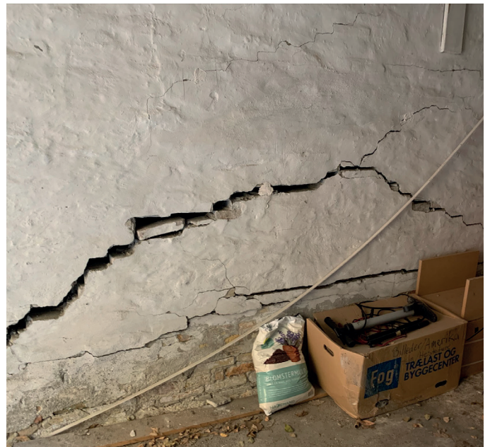
Revner og skader i facader udbedres.
