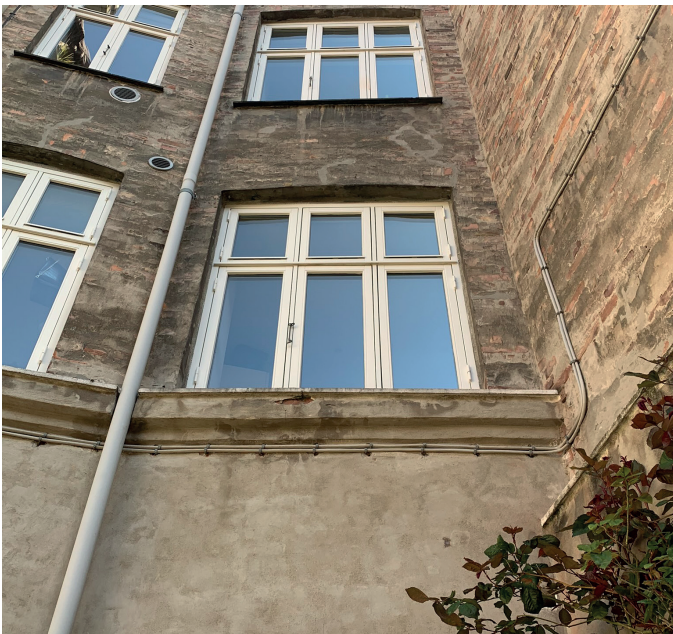
Ejendommens vinduer er i en ringe kvalitet.
