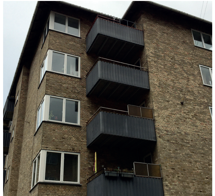
Altaner fjernes og udskiftes.
