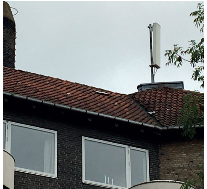
Taget er nedslidt.
