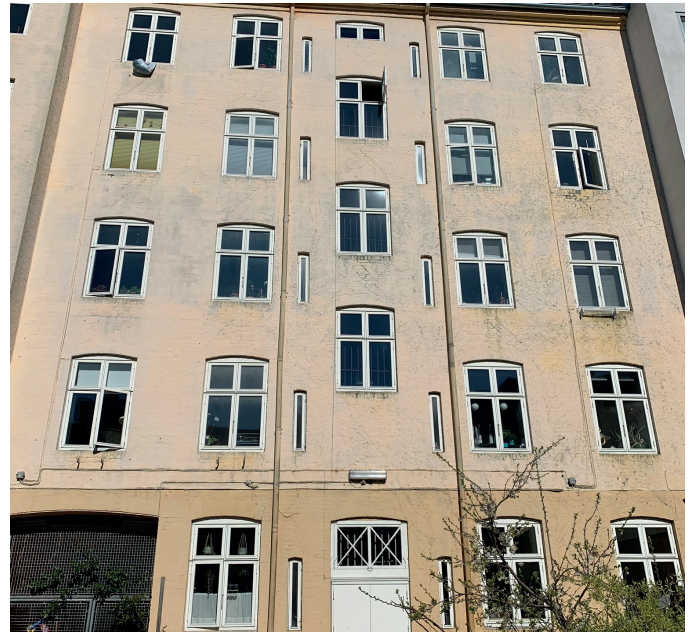
Ejendommens vinduer er utætte og udskiftes.
