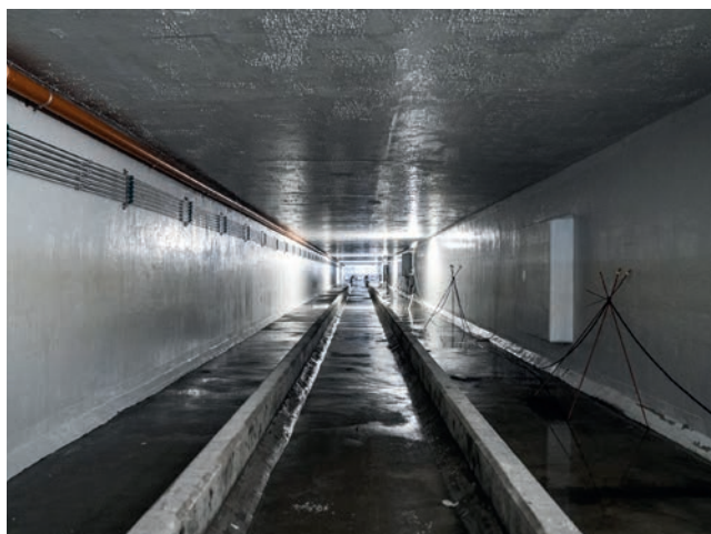
↑ Foto af bassin under Lyngbyvej/Helsingørmotorvejen (foto HOFOR)
