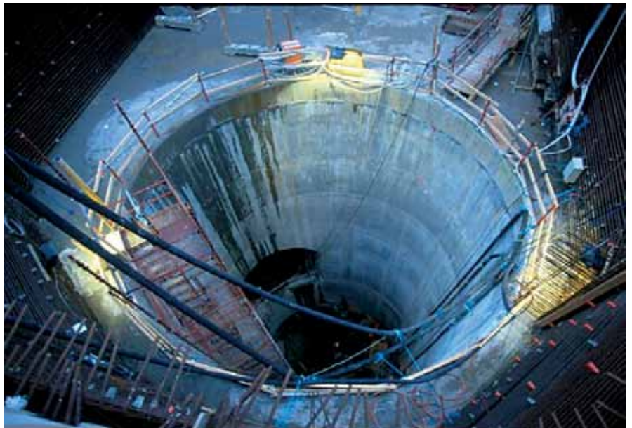
Figur 4.10 Skakt foret med beton på indersiden for opnåelse af jævn og tæt overflade, Københavns Metro.
