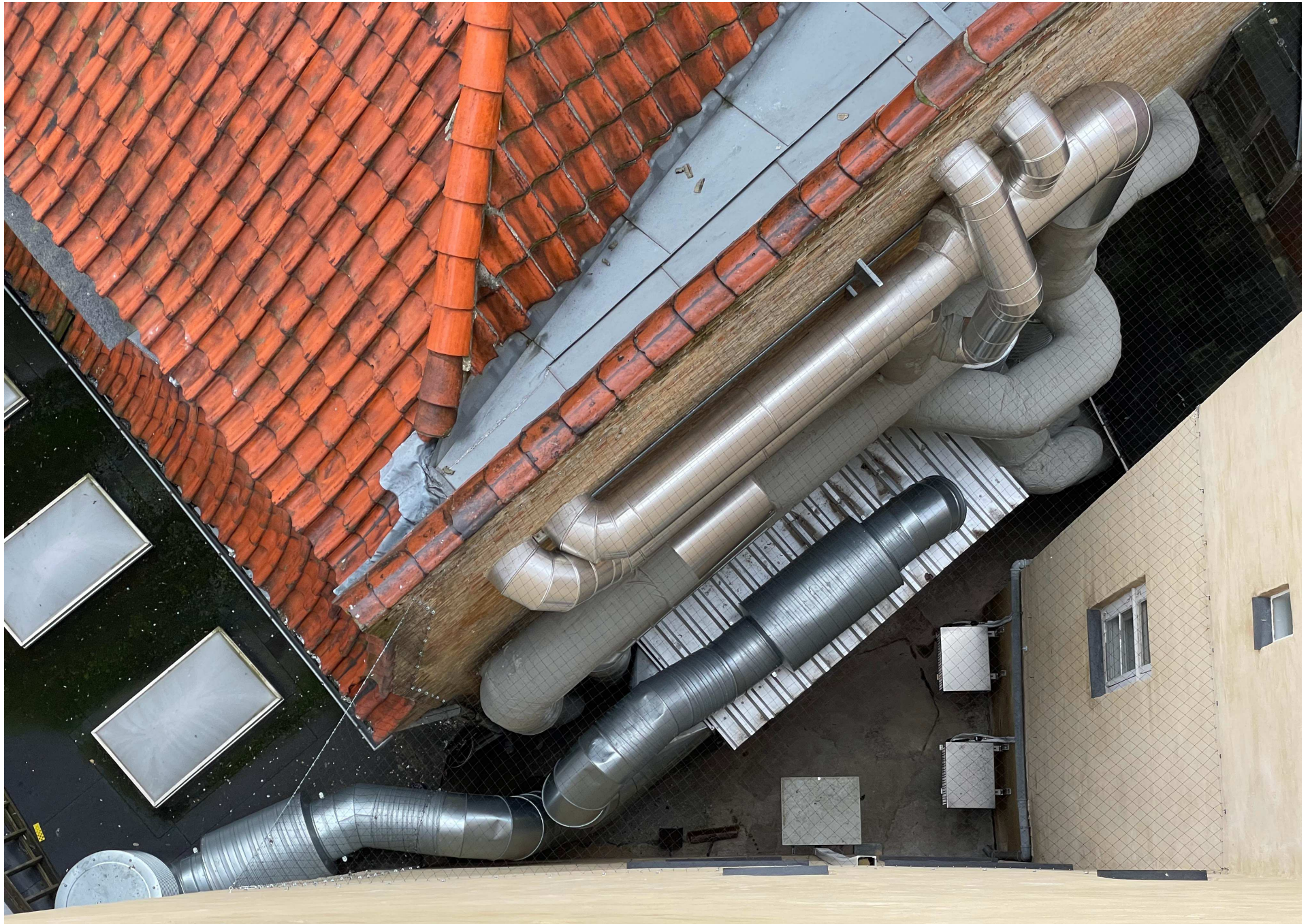
Bilag 2 af 2 for Svarnr. 4: 20250908T18-04_Ventilation Hauserplads 30.jpg
