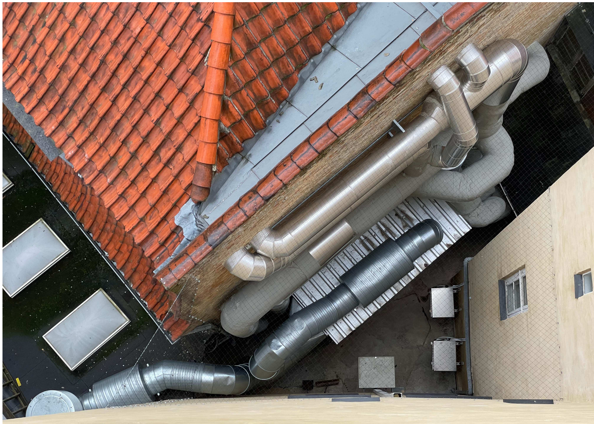
Bilag 2 af 2 for Svarnr. 4: 20250908T18-04_Ventilation Hauserplads 30.jpg
