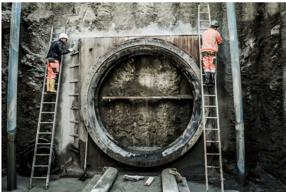
Damhusledningen - en bassinledning. Foto: HOFOR
