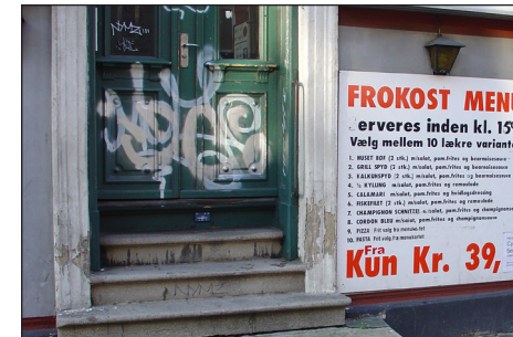
Mange facader har et hærgnet udseende.
