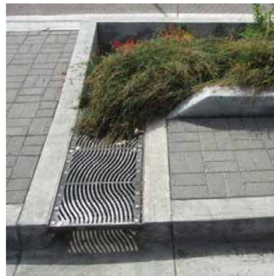
Grøn regnvandsforsinkelse langs gade i Portland, USA
