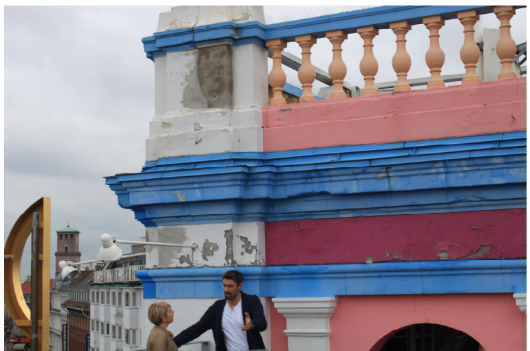
Tydelige skader på yderside af tårn
