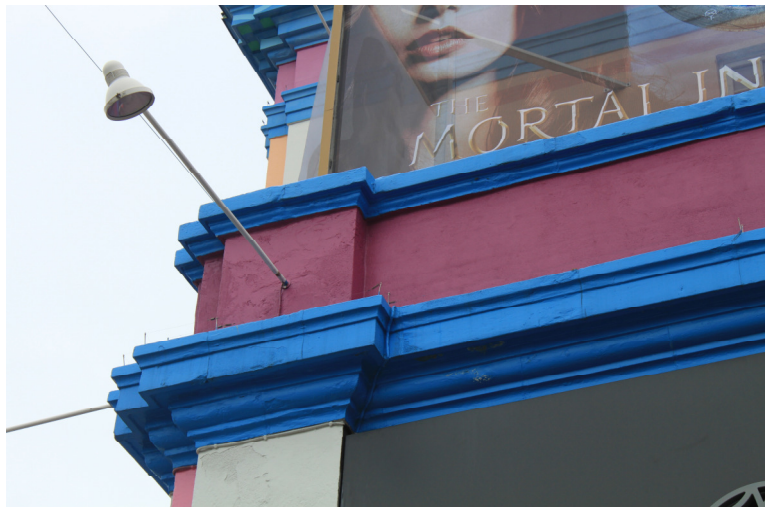
Belysningsstander på facade
