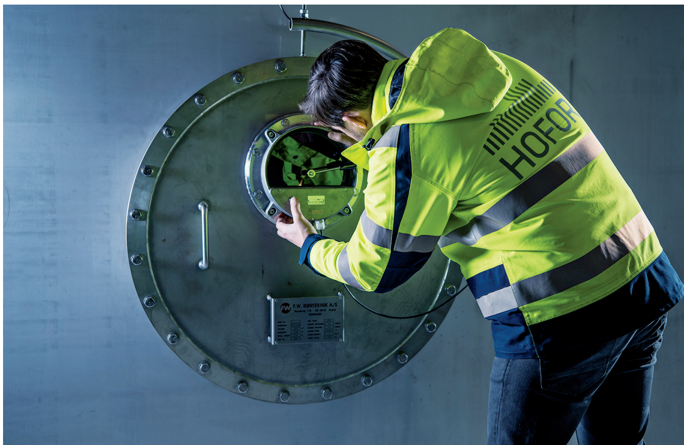
HOFOR er i gang med at renovere og modernisere vandværkerne. Værket ved Marbjerg er det første moderniserede værk, og i løbet af 2017 er Brøndbyvester Vandværk også færdigt - herfra kan HOFOR som noget helt nyt levere blødgjort vand.
