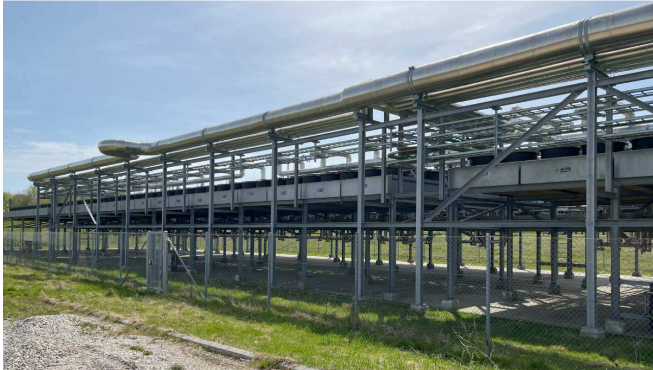
Figur 19 Luftoptag til luft/vand-varmepumpe på cirka 10 MW.
