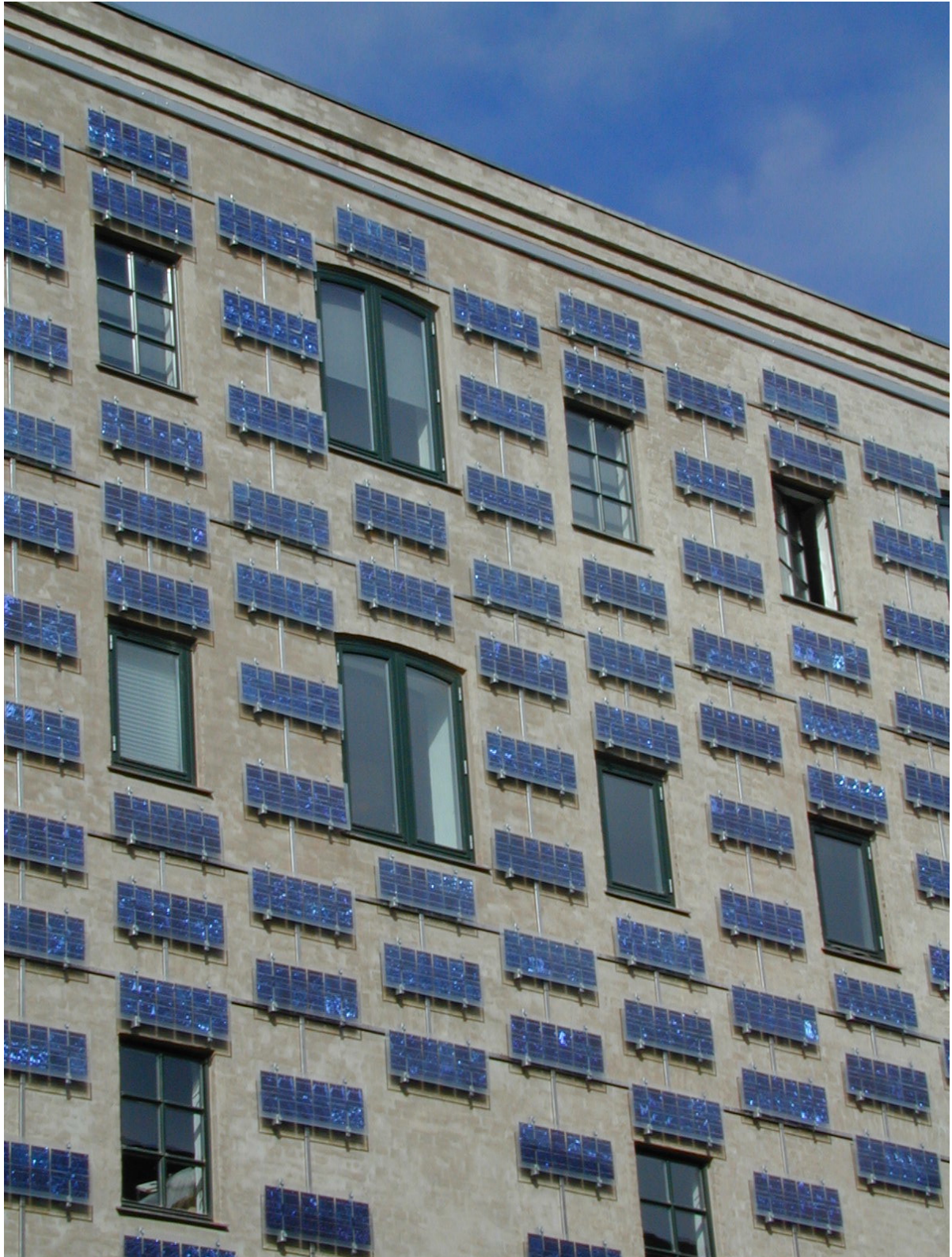
Solcelleanlægget på sydsiden af Gasværksvej 16, sidebygningen, producerer el til karreens fællesanlæg
